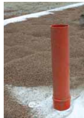
Herausragendes Inspektionsrohr DN 200
