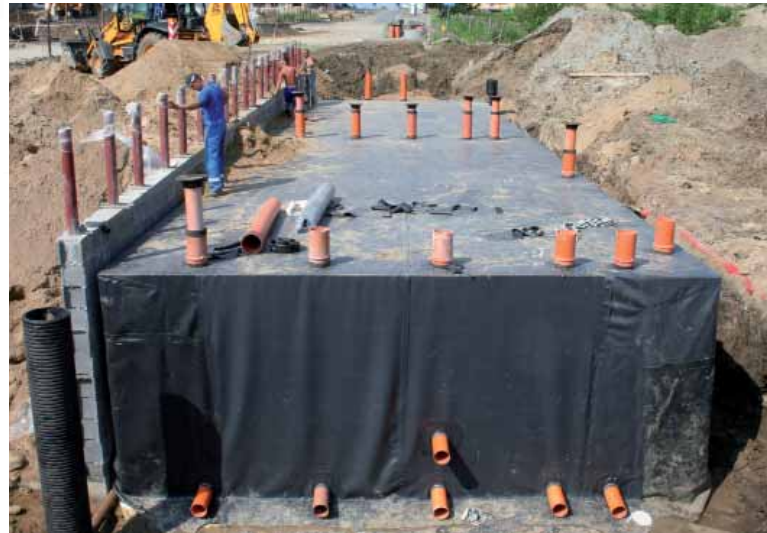
... als Zwischenspeicher im Regenwassersystem
